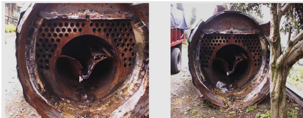
Figura N° 23 Siniestros en Calderos Pirotubulares
