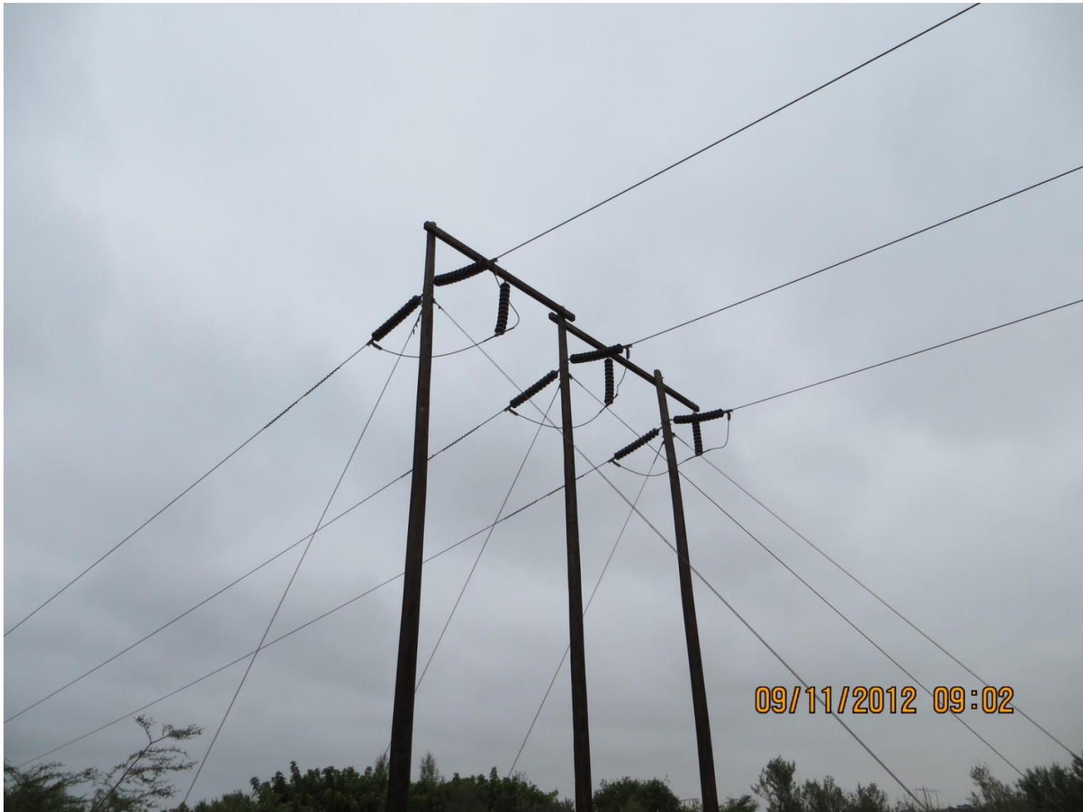
Linea de Transmisión de Potencia, Chimbote Sur –Nepeña: 138 Kv.
